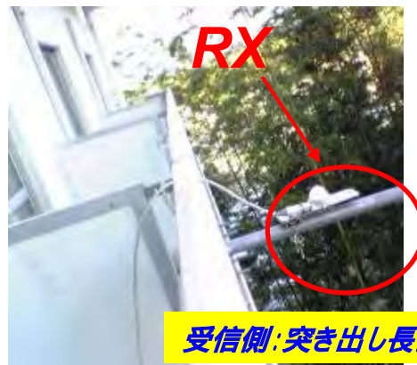
3Fに設置した受信装置
