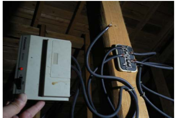
天井裏のブースターの電源と分配器
