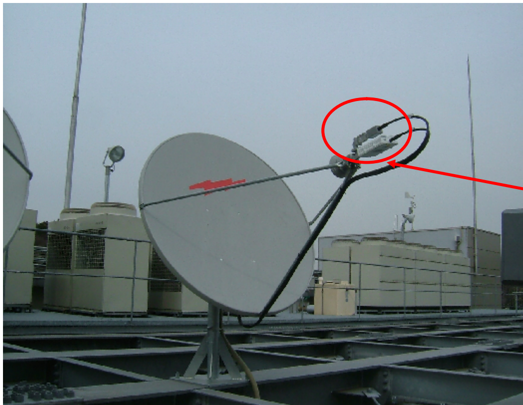
1.2mアンテナVSAT局
