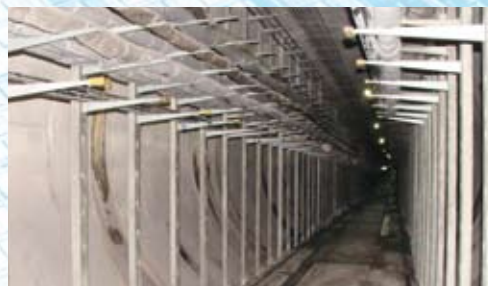
■とう道(NTTケーブル専用の地下トンネル)
