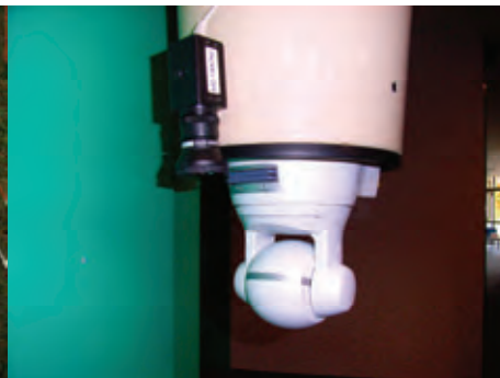
写真 4-2-11 全方位カメラ取付状態
